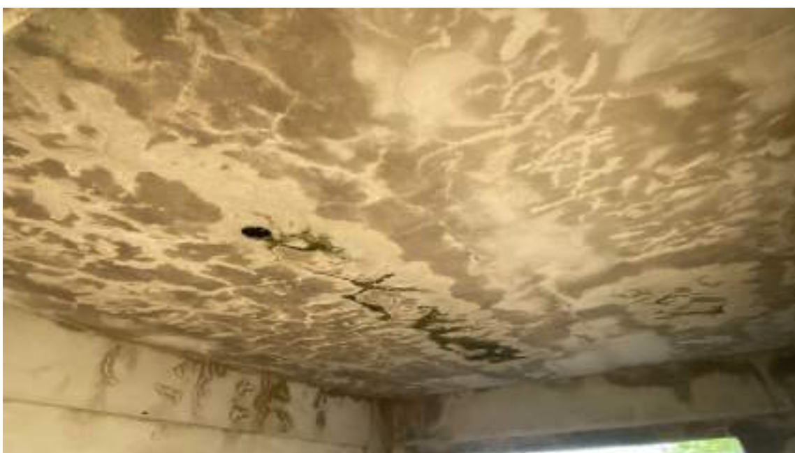
Figura 12 - Infiltrações no Forro.
