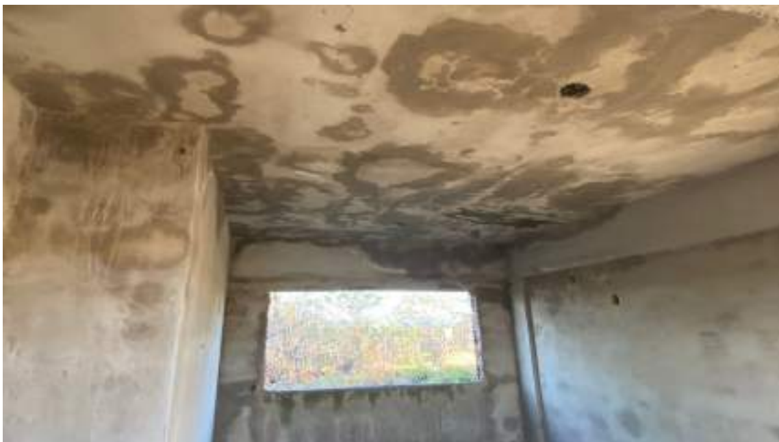
Figura 11 - Infiltrações no Forro.
